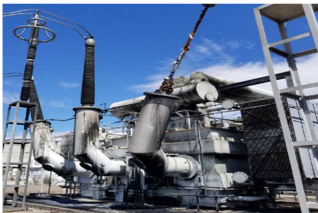
Рисунок 16: Трансформатор GSU после выхода из строя вводов фазы А
